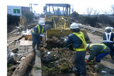
岩手県 大震災時の道路啓開
